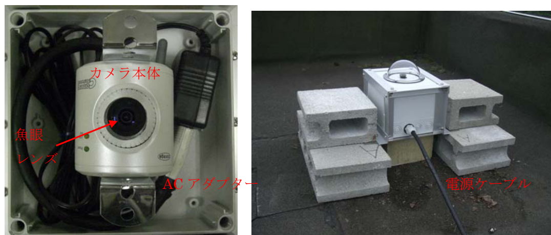
図 2-6 無線 LAN 型全天カメラの内部(左)と設置した全天カメラの外観(右)。無線 LAN にしたことカメラ内部がシンプルになり、接続するケーブルは 1 本のみとなった。カメラハウジングを支えているステンレス板をブロックで挟み、固定している。
