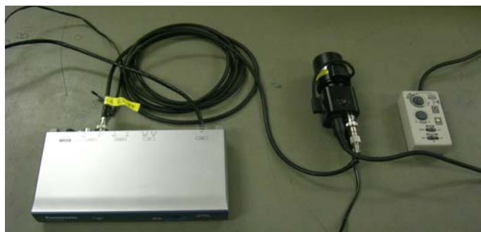
図 3-6 ネットワークカメラサーバーとカメラの接続。左からネットワークカメラサーバー、カメラ本体、カメラのコントローラー。カメラから映像ケーブルをカメラサーバーに接続し、カメラサーバーに LAN ケーブルを接続することでインターネット上に配信する。
